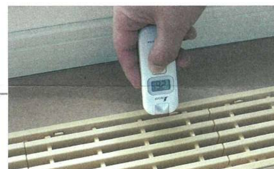
エアコン1台による床吹き出しの暖房。温度計は26℃を示している(施工地:八雲町)
